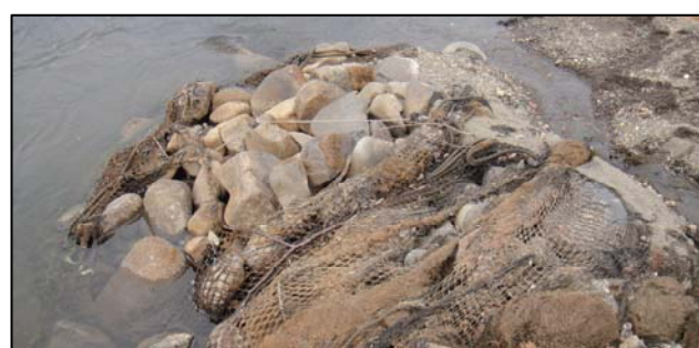
図 - 15.1.55 分流堰の構造が一部破損
