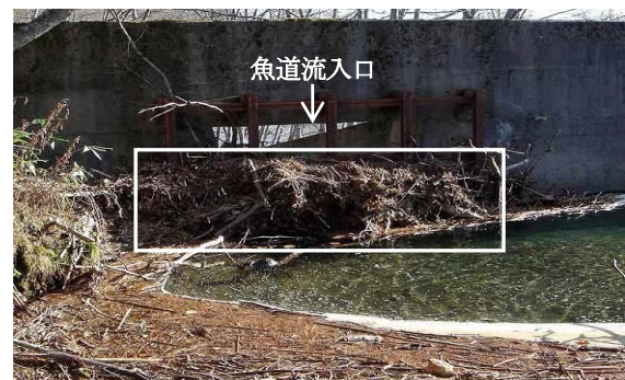
写真-11 流木が堆積した魚道流入口上流部
