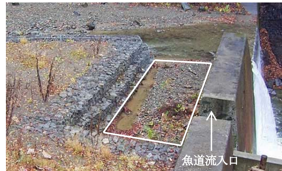
写真-10 砂礫が堆積した魚道流入口上流部
