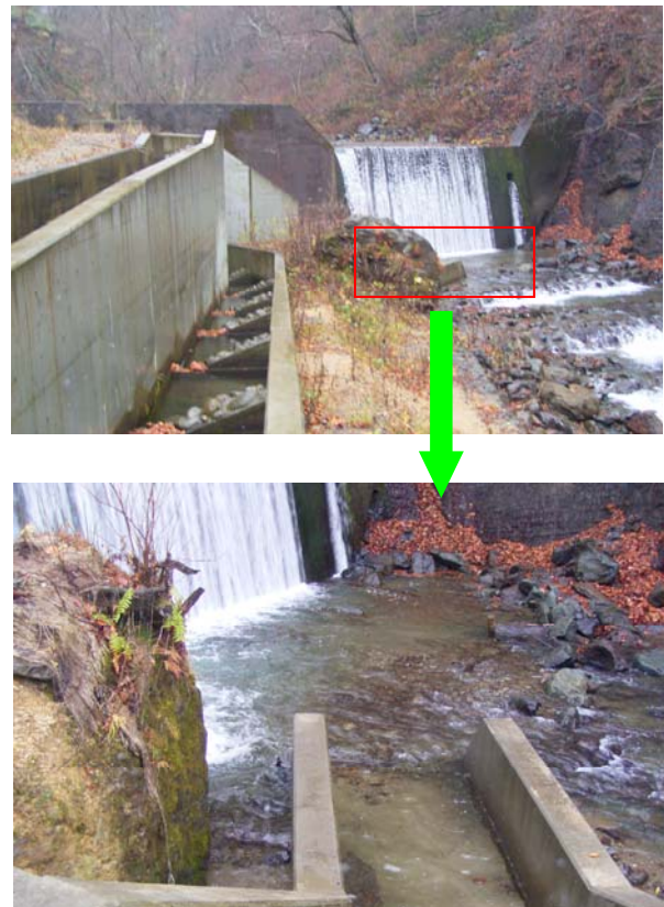
写真-15 堰堤下流部において落下対策が考慮されていない状態
