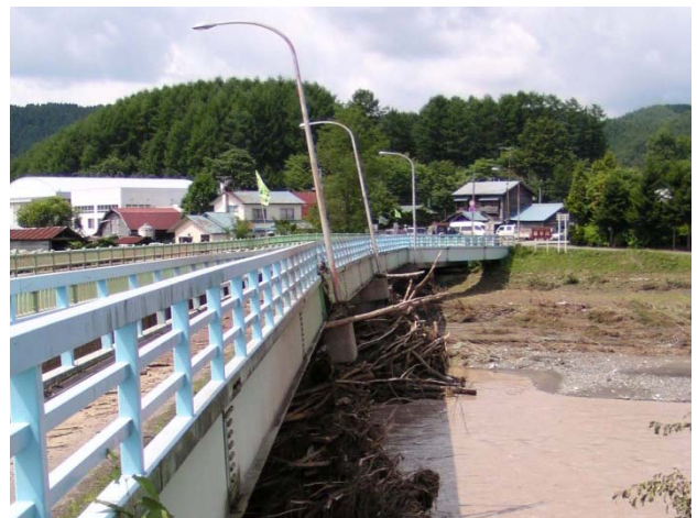
図-15.5.2 2003年8月沙流川出水時における額平川貫気別橋
