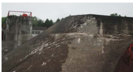
写真-1 堰柱部の凍害ひび割れ
