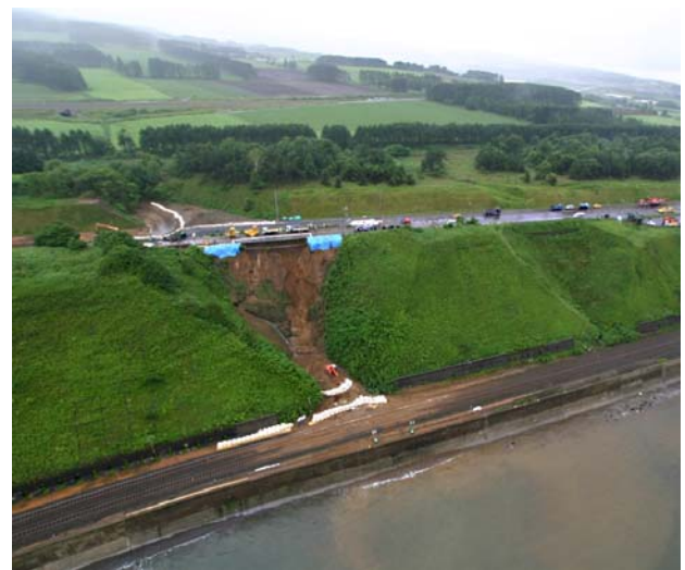
写真-3 谷埋め盛土の路肩崩壊の事例 (管轄事務所提供)
