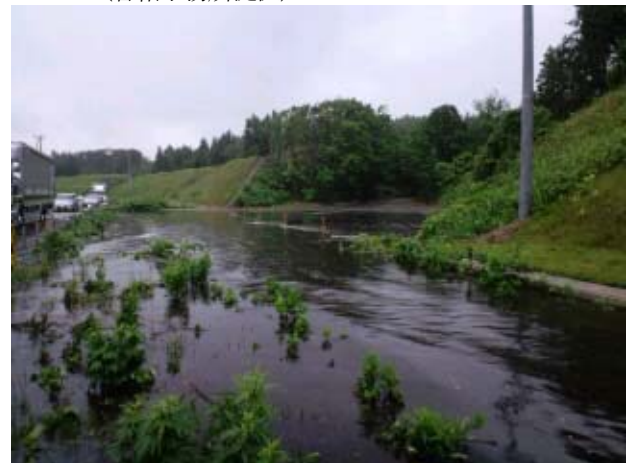
写真-4 道路周辺に溢れた表流水 (管轄事務所提供)
