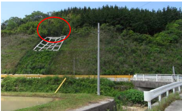
写真-9 小規模な谷地形（赤丸内）の直下の切土のり面の崩壊事例
