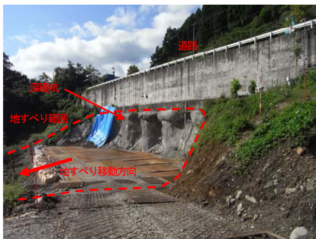
写真-8 道路直下で発生した地すべりの事例 (管轄事務所提供)
