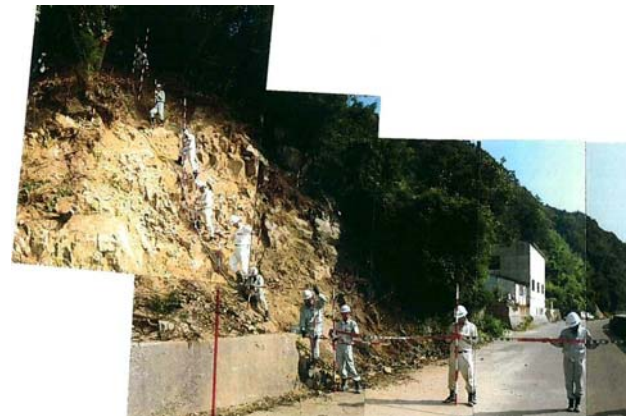
(a) 災害後（管轄事務所提供）
