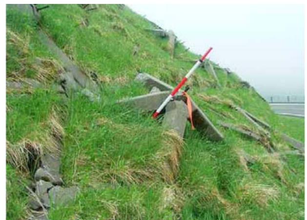
写真－７ プレキャストのり枠工の浮き上がり (管轄事務所提供)
