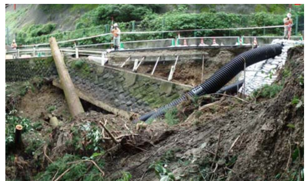
写真-1 豪雨による路肩崩壊の事例（管轄事務所提供）
