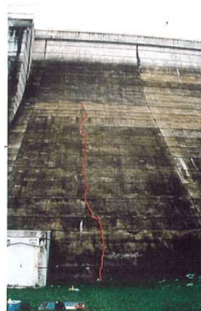
写真-2.4.1 堤体のコンクリート面に見られる鉛直方向のクラック
