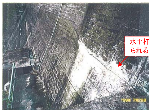
写真-2.4.2 堤体の水平打継面に見られるクラック
