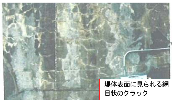
写真-2.4.3 堤体表面に見られる網目状のクラック
