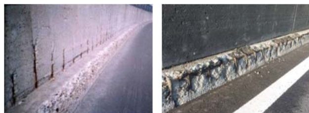
写真-1 積雪寒冷地における壁高欄の劣化事例
