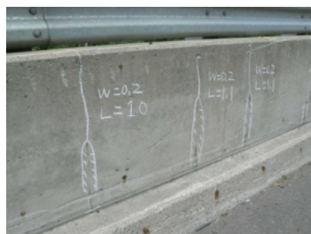
(b) 鉄筋腐食による浮き
