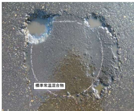
写真-5 標準常温混合物の損傷状況 (700 台通過後)
