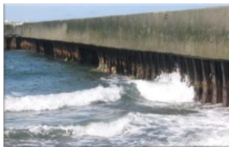
図-1 オホーツク海に面した導流堤の鋼矢板の損傷例
