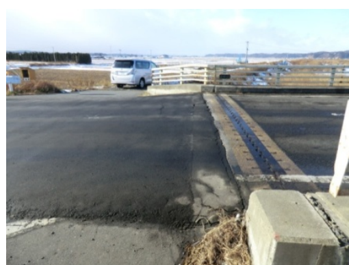
①踏掛版なしの事例 (段差20cm程度)
