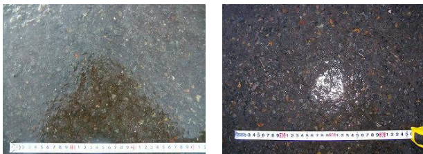
写真-1 凍結路面状況
