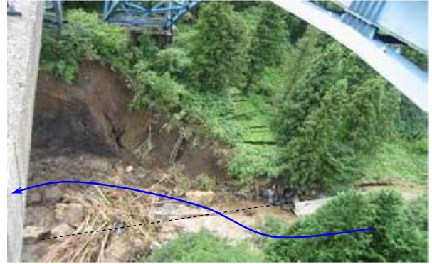
写真-4 河岸浸食による橋梁基礎の下方斜面の崩壊事例（管轄事務所提供）
