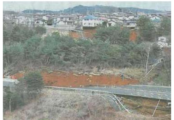
写真-5 東北地方太平洋沖地震による谷埋め盛土の崩壊事例（管轄事務所提供）
