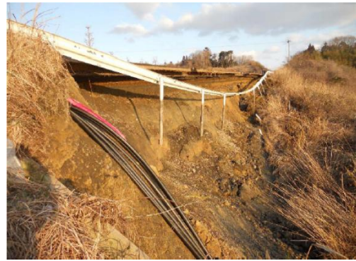
写真 1 崩壊状況（事務所提供）
