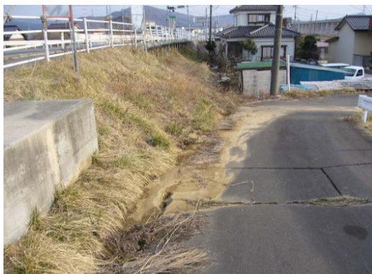
写真27 噴砂跡の状況
