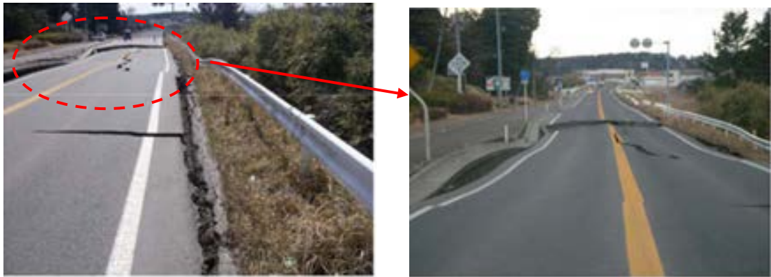
写真12 被災状況（事務所提供）
