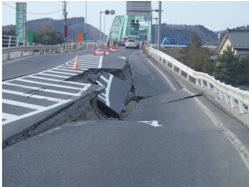
写真23 被災状況（事務所提供）
