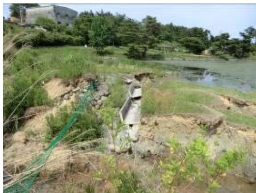
写真21 基盤部の流動状況
