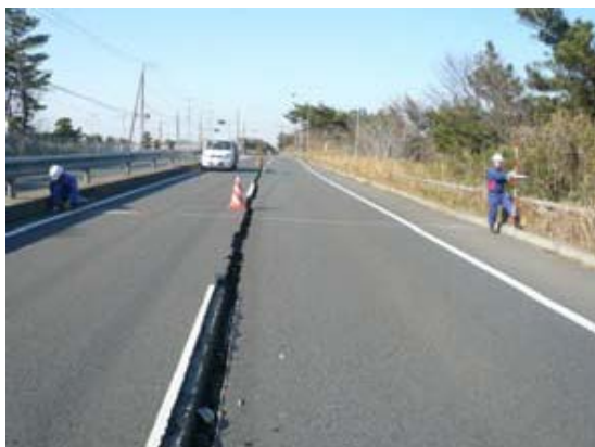
写真29 被災状況 (事務所提供)
