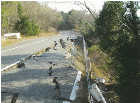
(a) 被災状況
