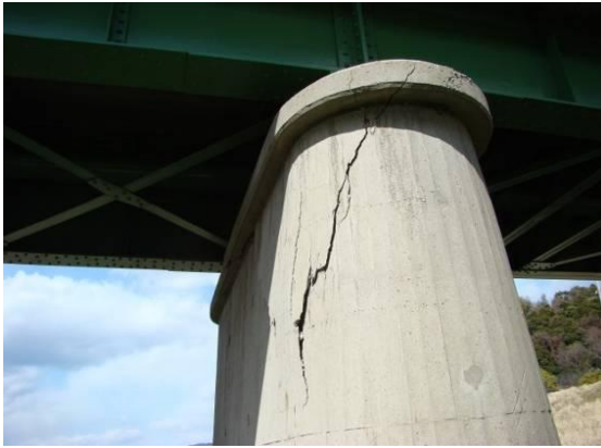
写真-5.1 壁式橋脚における橋座部のせん断破壊 17)
