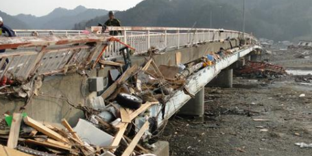
写真-2 橋桁が流出しなかった橋梁
