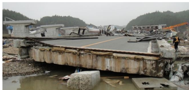
写真-4 橋桁が裏返しにならずに流出した橋梁
