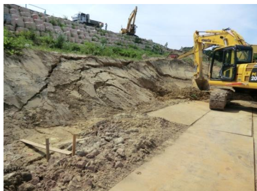
写真4 復旧作業中ののり尻部の小崩壊
