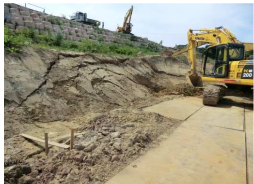
写真4 復旧作業中ののり尻部の小崩壊
