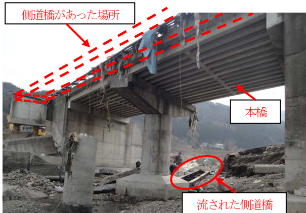
写真-5.1 側道橋は流出したが、本橋は流出しなかった例（浪板橋）
