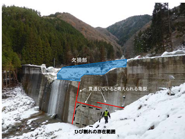
図-7 南梨子沢堰堤のひび割れ位置
