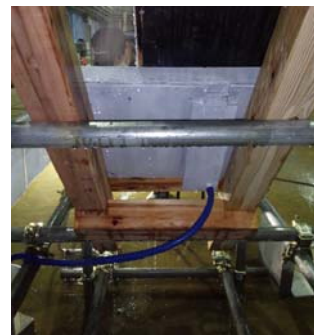
(b) ひび割れ背面での集水
