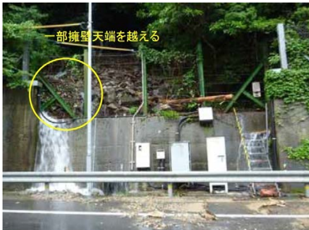
写真-11 土石流事例 (図-11 ①の事例)
