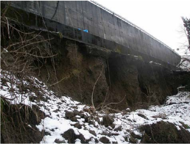
写真-16 路肩・盛土崩壊事例 (図-12 ③の事例)
