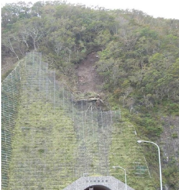
写真-5 自然斜面崩壊事例 (図-7 ②の事例)
