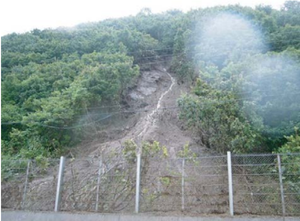
写真-3 自然斜面崩壊事例 (図-7 ①の事例 1回目の崩壊)
