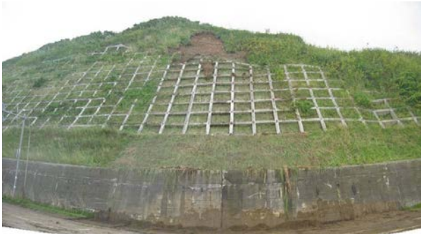
写真-1 切土のり面崩壊事例 (図-6 ①の事例)
