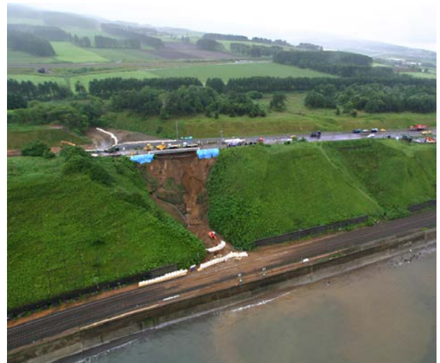
写真-15 路肩・盛土崩壊事例 (図-12 ②の事例)
