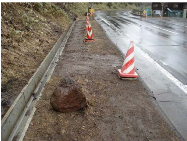
写真-8 落石事例 (図-8 ②の事例)
