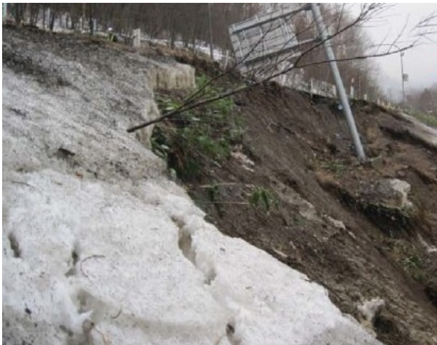
写真-14 路肩・盛土崩壊事例 (図-12 ①の事例)
