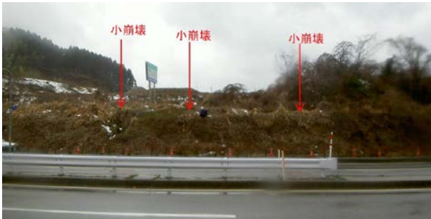
写真-2 切土のり面崩壊事例 (図-6 ②の事例)
