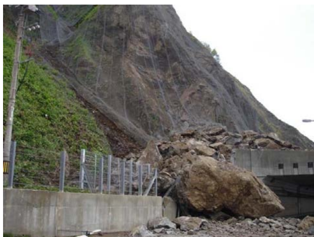
写真-9 岩盤崩壊事例 (図-9 の事例)
