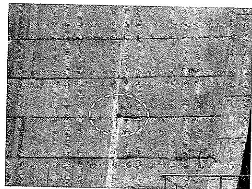
写真-3.8 剥離部の可視画像
