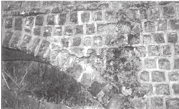
図-3 石材劣化の例(風化による剥離)
