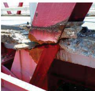
破断した鋼材、上下が完全に分離している
