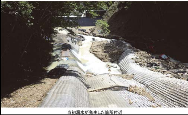
当初漏水が発生した箇所付近
