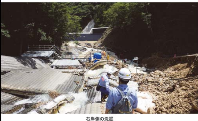
右岸側の洗掘
