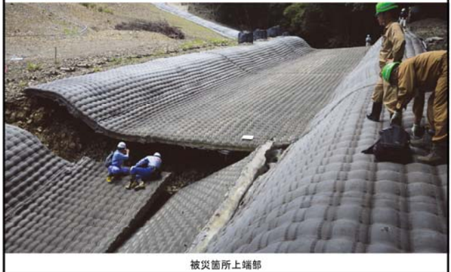
被災箇所上端部
