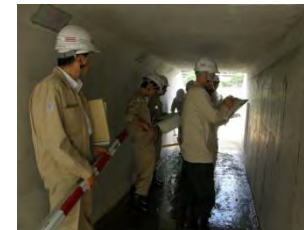
露筋・漏水の確認
