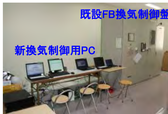
新換気制御の状況【電気室内】
