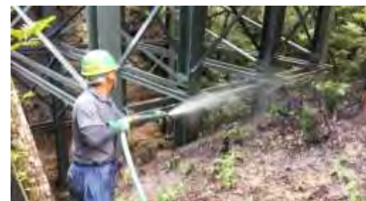
工事荒廃箇所への適用例
