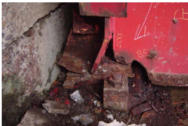
写真-1 鋼橋桁端部の腐食と震災の事例 *) 震災前に、支承付近の鋼桁に、腐食による著しい断面欠損が発生していた。
