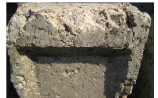
ローモンによる劣化
