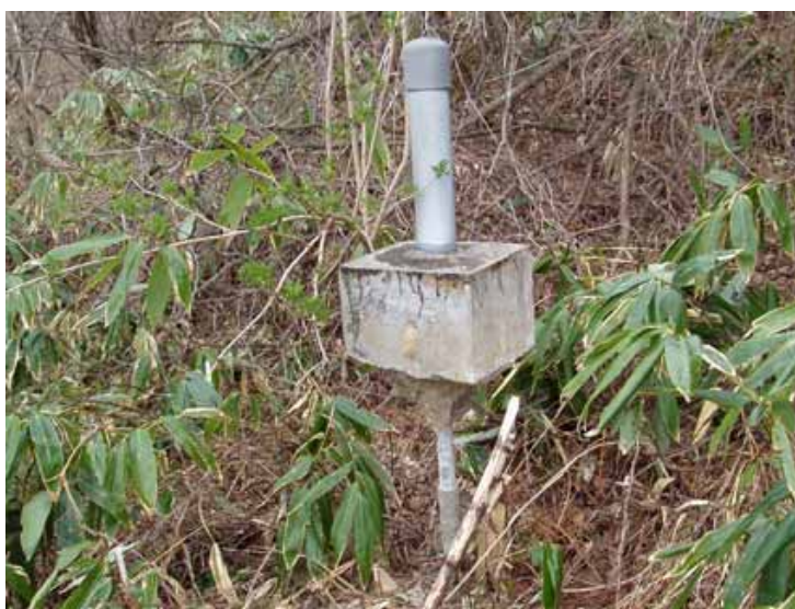
写真-3-1-1-1 孔内傾斜計ガイドパイプの浮き上がり例（富山県胡桃地区）
