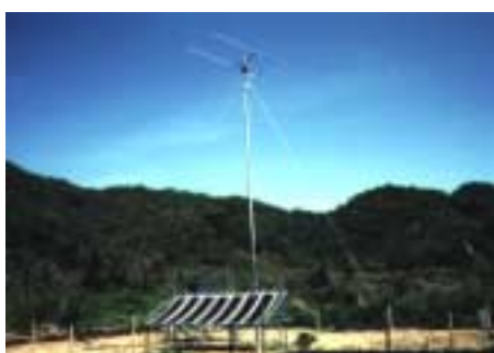
写真 1 マルチテレメトリシステム受信局設置状況
