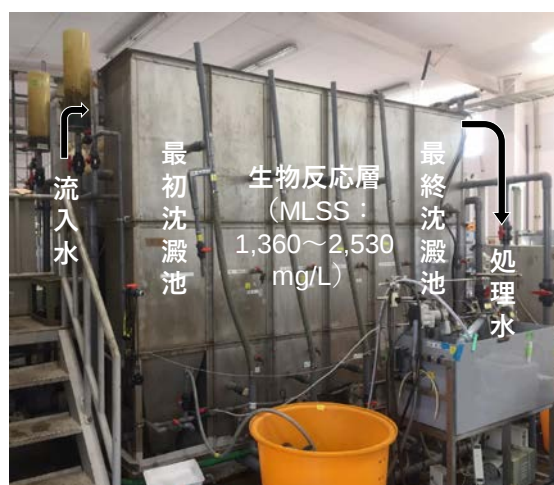
図-1 標準活性汚泥処理装置
