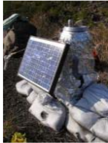
設置状況 (昭和溶岩地点)
