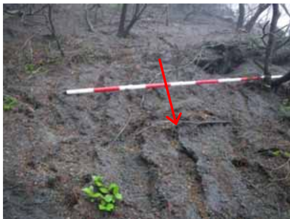
5月10日現地確認リル侵食状況
