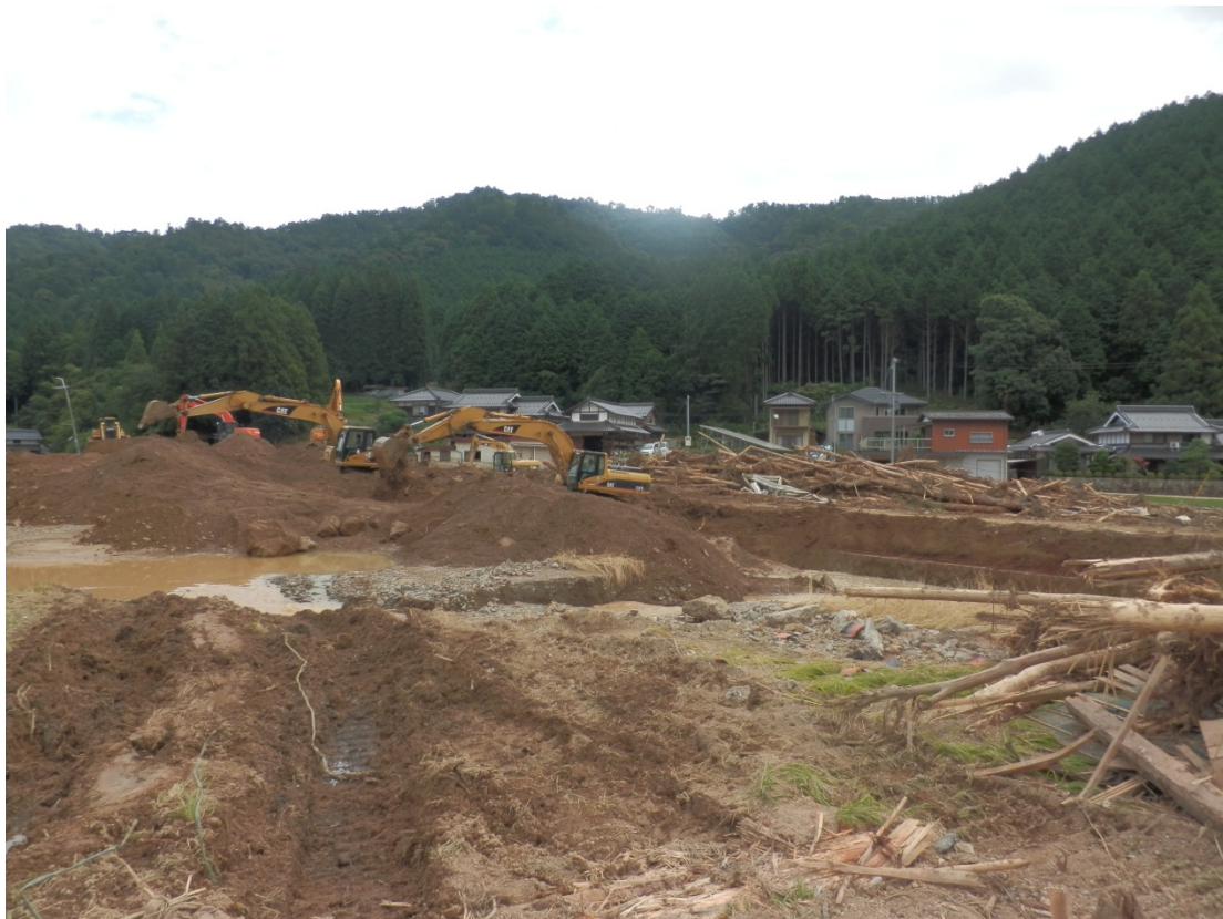
写真-11 下流域における氾濫の様子（寺奥谷川）
