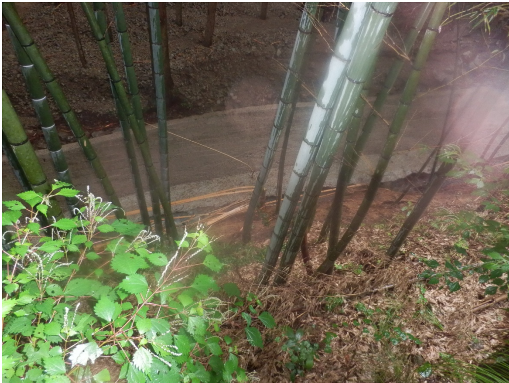
写真-19 流路工の破損（大原谷川）
