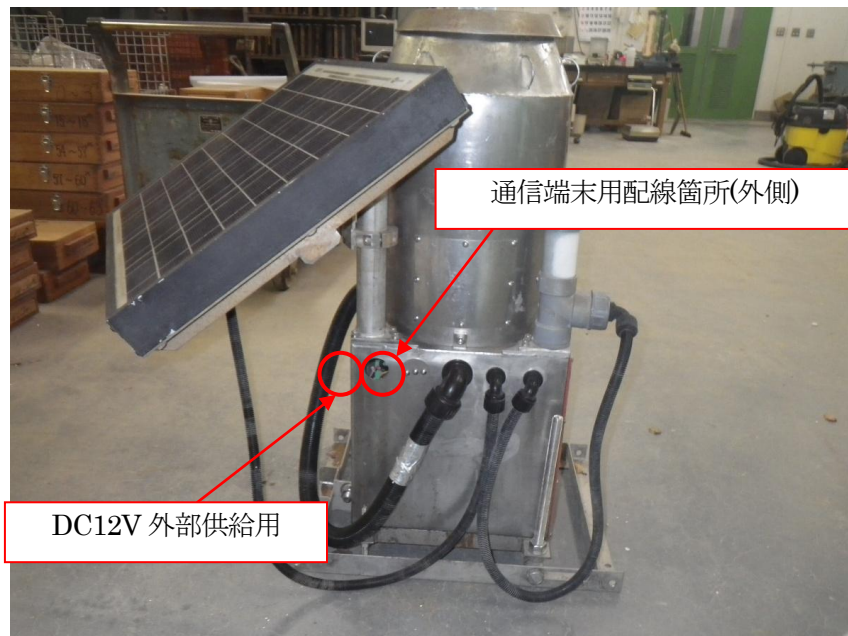
図 8 通信端末、外部電力供給箇所
