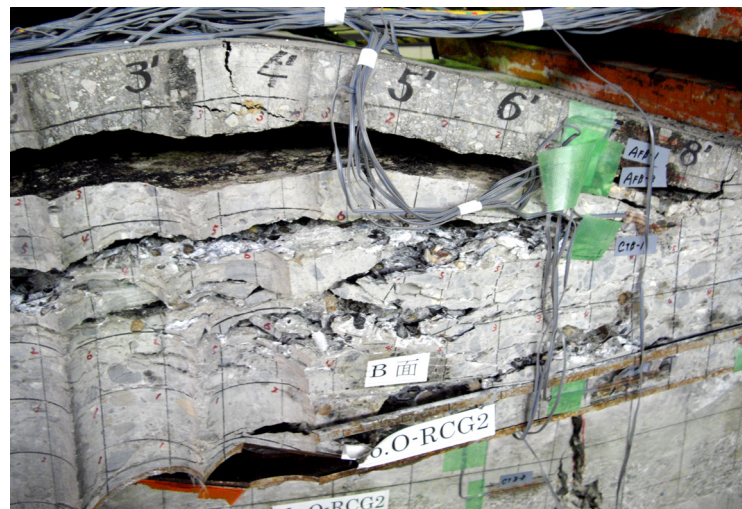
圧壊付近の上フランジ側面の状況
