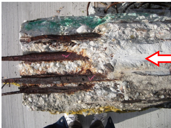
露出した鉄筋
