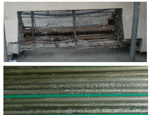
撤去桁下桁の解体調査 PC鋼線の腐食による断面減少の状況
