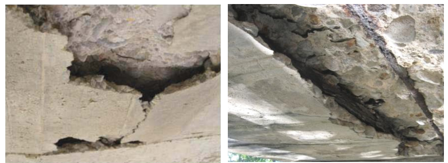
床版下面の剥離
