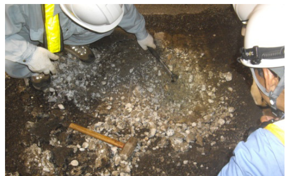
(b) 鉄筋が露出するまで工具で掘れる状態
