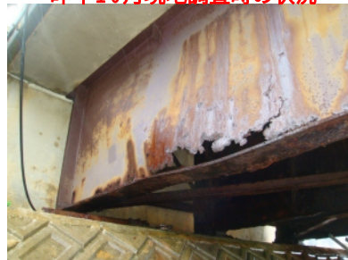
外桁の状況 (フランジ・ウェブ間破断、座屈)
