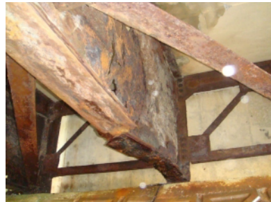
中桁の状況 (下フランジ破断)
