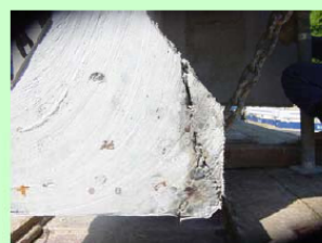
鋼材の配置、腐食状況
