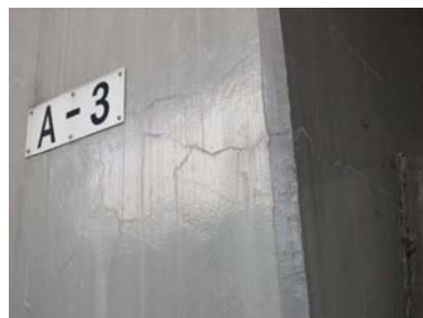
ASR対策が施されたRC橋脚のその後の状況に関するフォローアップ調査
