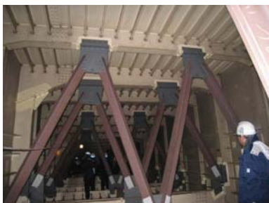
鋼製箱桁内に生じた疲労亀裂の対策として平成3年に実施されたトラス組によりダイヤフラムの補強がなされた橋のフォローアップ調査
