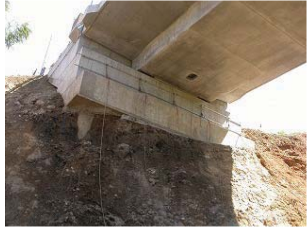
周辺地盤の崩落に伴う杭頭部の露出 (2004年新潟県中越地震)
