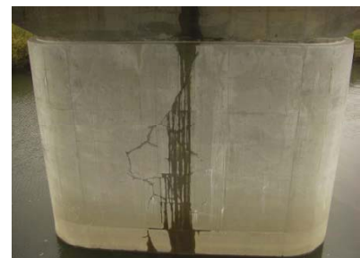
RC巻立て工法による耐震補強後に巻立て部のコンクリート表面にひび割れが生じた事例の調査
