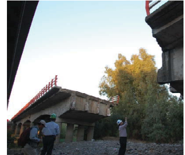
落橋したゲルバー橋のヒンジ部の調査
