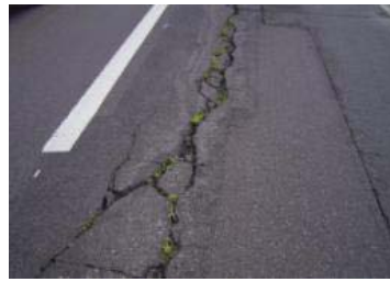
車道部の凍上
