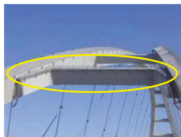
下路橋の着冰雪対策工 (格子フェンス)
