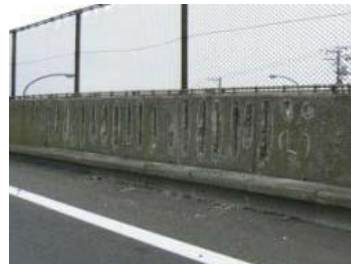
壁高欄の凍害・塩害 (外面は問題なし)
