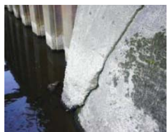
凍害劣化(スケーリング)
