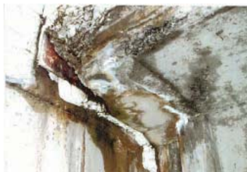
床版張出部のスケーリング
