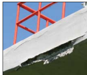
断面修復部の再劣化
