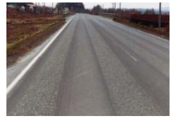
摩耗わだち掘れ
