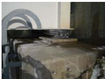
沓座部への凍結防止剤・ 融雪水滞水
