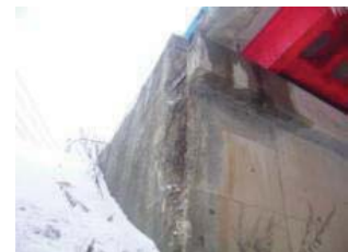
橋台のスケーリング
