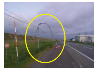
固定式視線誘導柱(除雪作業 用の幅員を示す)の疲労損傷
