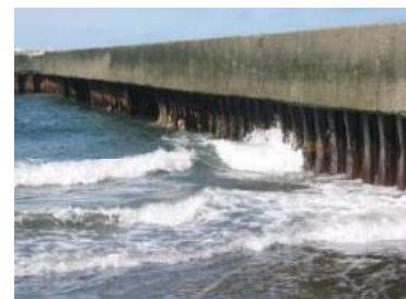
二重矢板式導流堤の海水作用と腐食による矢板の変形
