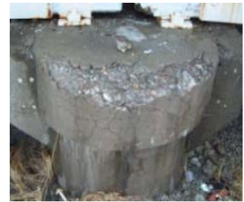
橋脚のスケーリング・ひび割れ →急速な劣化進行
