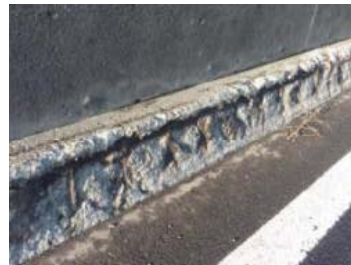
地覆部のスケーリング
