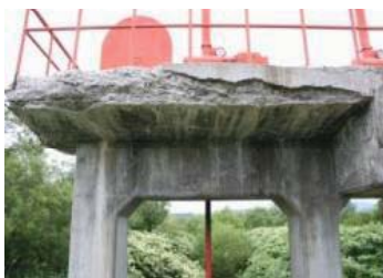
凍害劣化(スケーリング・剥落)
