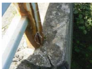
防護柵支柱の凍結膨張亀裂、 支柱基礎(地覆)のひびわれ
