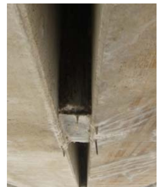
PC桁下面部の遊離石灰
