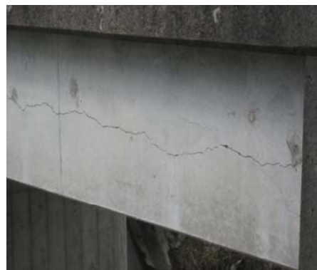
PC桁側面部のひび割れ
