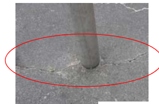
関連部位の損傷
