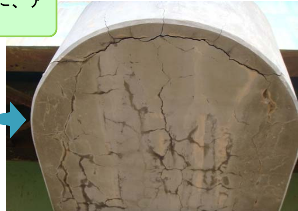
橋脚はり部のひび割れ状況
