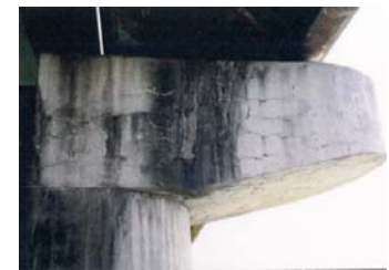
橋脚部分のひび割れ
