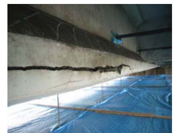
塩害(能生大橋)
