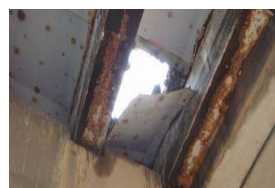
接着鋼板のため 床版の劣化状況の把握困難
