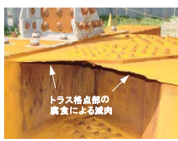
トラス格点部の腐食状況
