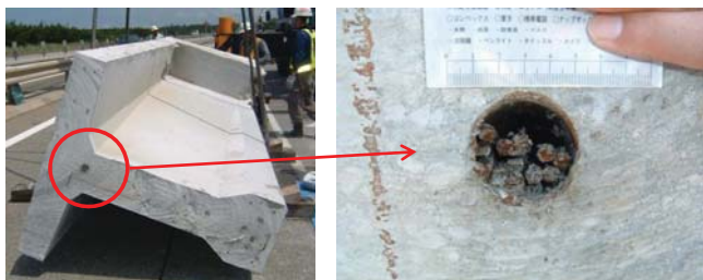
床版付近の曲げ上げ部でグラウト未充填部を確認
