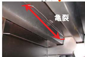
鋼床版で発見された亀裂
