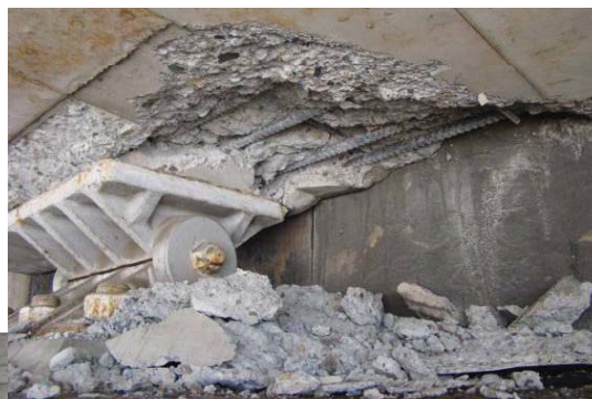
上部構造側の損傷
