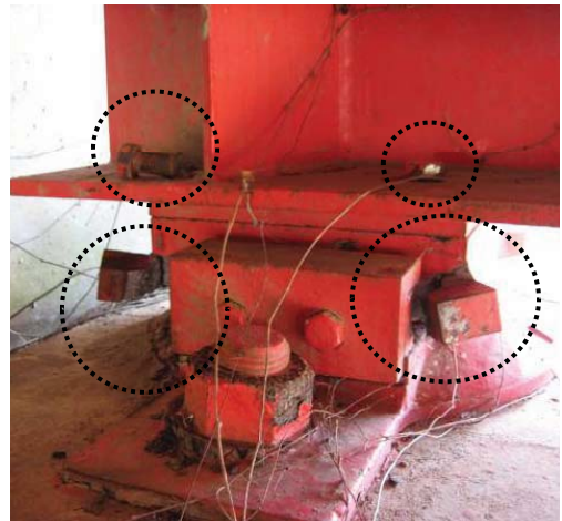
固定支承の損傷
