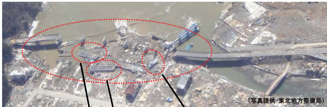
上部構造の一部径間が流出した橋
