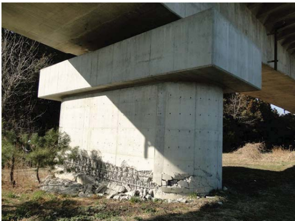
地震動による被害
