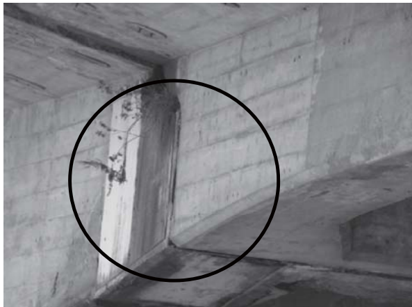
隙間部の変状確認は？
