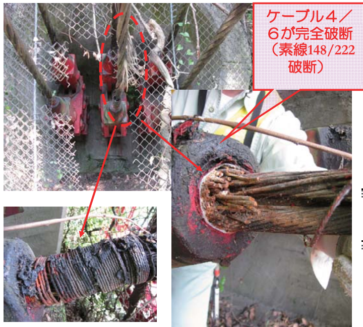
ラッピングワイヤーの状況
