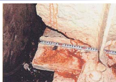
桁端部の腐食による断面欠損
