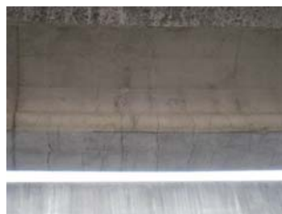
主桁に多くのひび割れ
