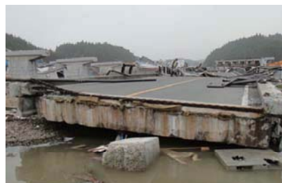
橋桁が裏返しにならなかった橋
