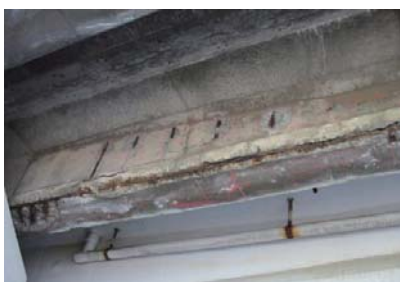
塩害による鉄筋腐食により剥落
