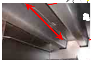
鋼床版で発見された亀裂
