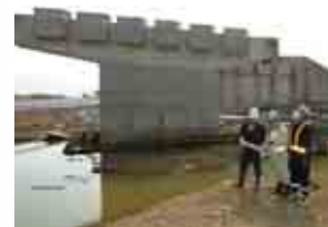
地震による落橋
