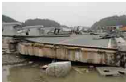
橋桁が裏返しにならなかった橋
