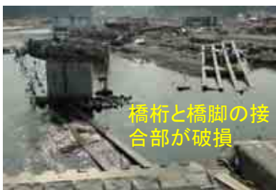
橋桁が裏返しになった橋
