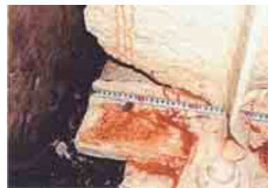
桁端部の腐食による断面欠損
