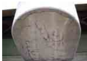
ASRIによる損傷
